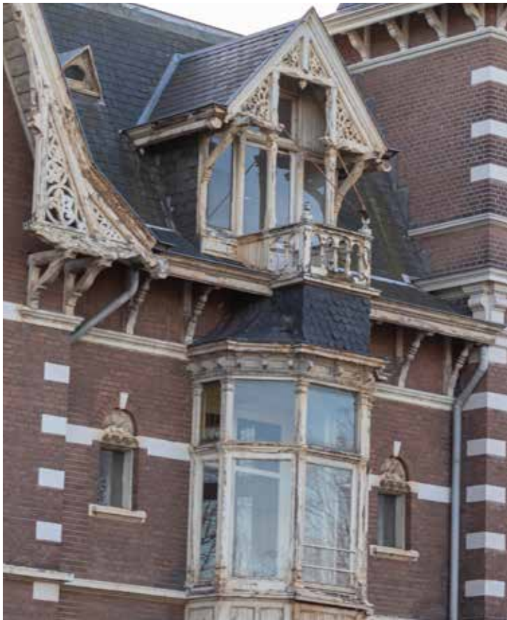
De houten gevelelementen verkeren in beroerde staat.
